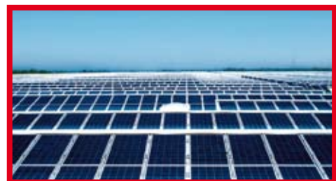
Veduta d'insieme dell'impianto fotovoltaico.
